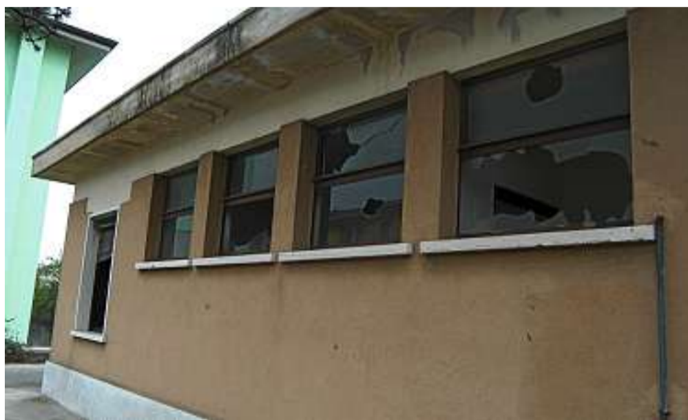
La palazzina nell'area della stazione che sarà riqualificata dal Comune. FOTO PECORA
