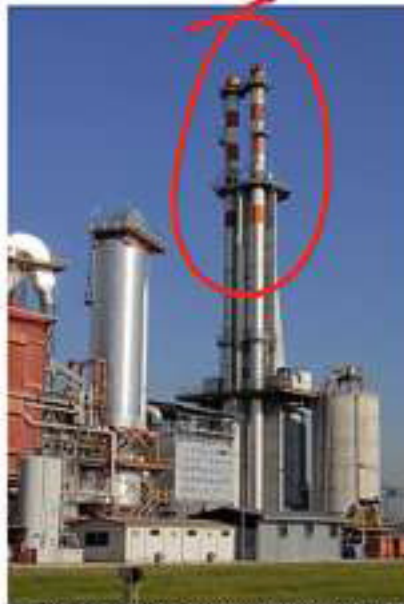
Porzione dell'impianto sempre "tagliata fuori" dalle precedenti foto di Agsm
